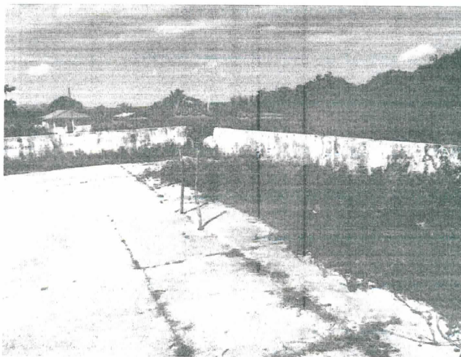
Foto 04 – Vegetação e rachaduras.
