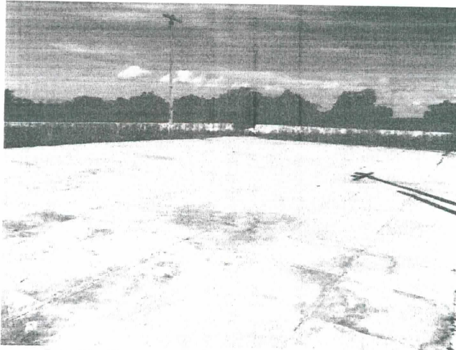
Foto 01 – Vista panorâmica com rachaduras e vegetação
